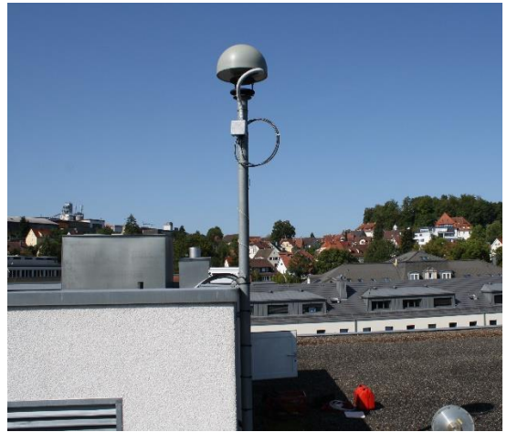
Abbildung 2 Dachstation in Sigmaringen, zu sehen ist nur die Antenne auf dem Mast, die restliche Hardware befindet sich im Gebäude
