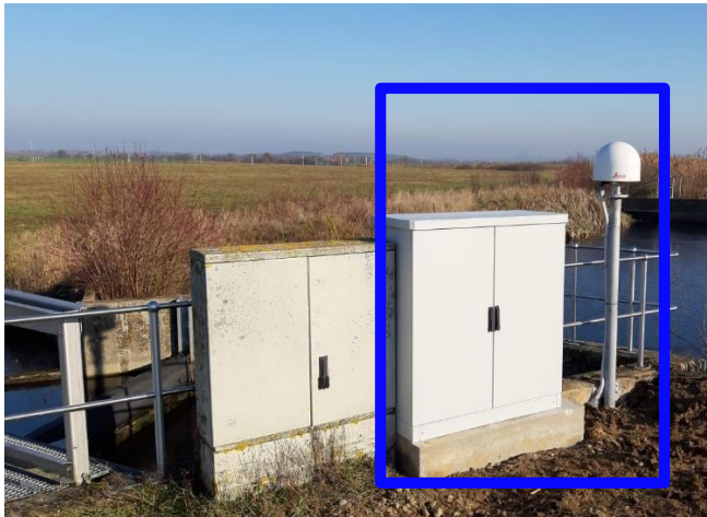
Abbildung 1 Bodenstation in Schwäbisch Hall bestehend aus Schaltschrank(rechts) und Antenne auf Pfeiler
